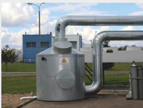
Filtr siloksanów w Łodzi 1300 Nm 3 /h
